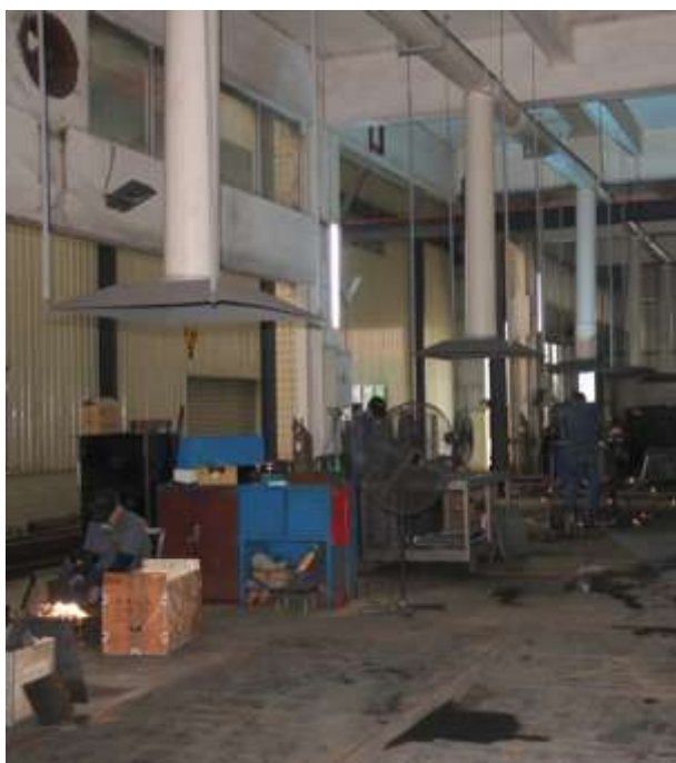
图 3-6 焊接车间和集气罩
