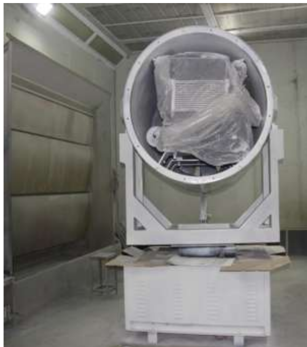
图 3-5 喷漆房和水帘柜
